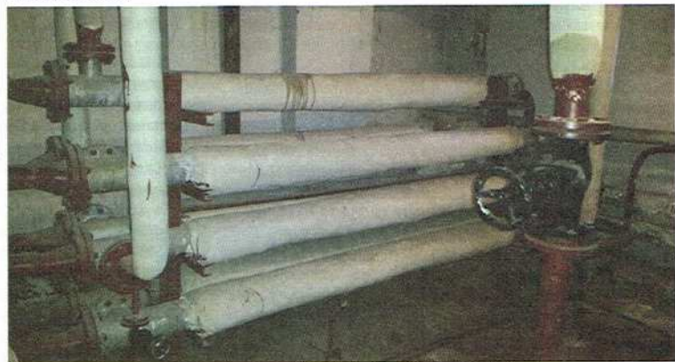
Węzeł cieplny na osiedlu „Spokojnej Starości” przed modernizacją.
