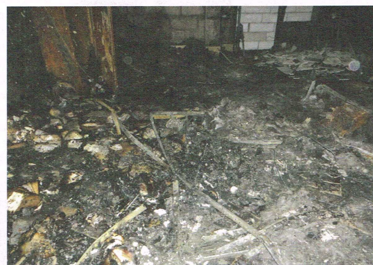
Doszczętnie spalona dyspozytornia
