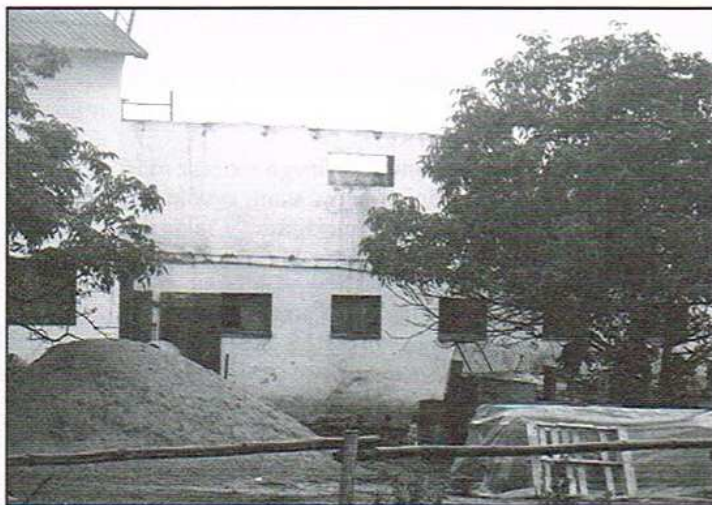
Po pożarze... chlewnia bez dachu
