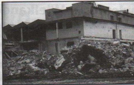
Na terenie nieruchomości przy ulicy Łęczyskiej, należącej do Toniego Kamala, trwa rozbiórka budynków po byłych zakładach Latony
