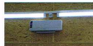
Nowe punkty świetlne oraz nagrzewnica elektryczna z nadmuchem w budynku komunalnym w Sokolnikach-Parceli
