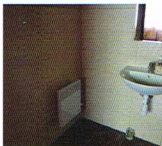
Grzejnik elektryczny w toalecie w budynku komunalnym w Sokolnikach-Parceli
