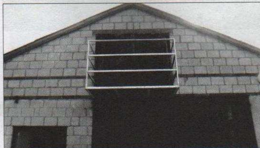
Foto: W gospodarstwie laureata pierwszego miejsca otwory ścienne budynków gospodarczych posiadają zabezpieczenia przed wypadnięciem
